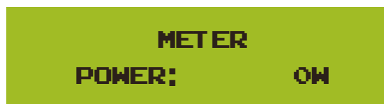
Foto 7.6 Potência do medidor
