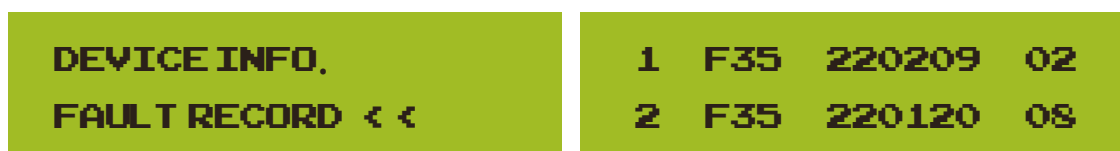
Foto 7.13 Registro de falha
